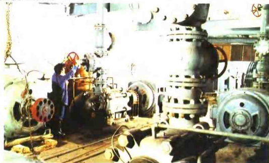
矿务局甲二矿井下中水泵房。
