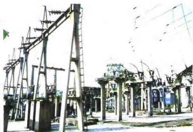
合山矿务局总配电站
