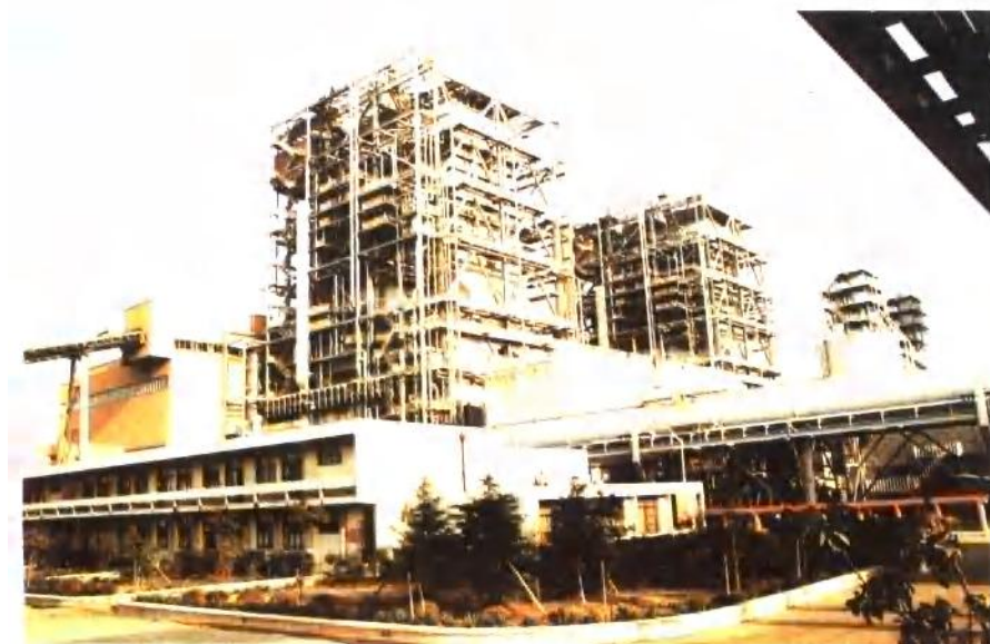
电厂1160吨/时锅炉
