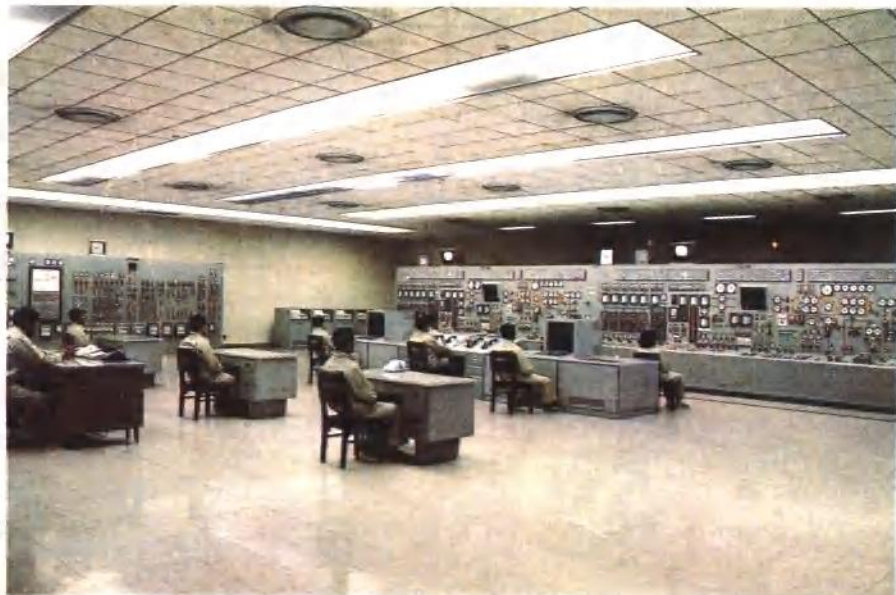
电厂中央控制室
