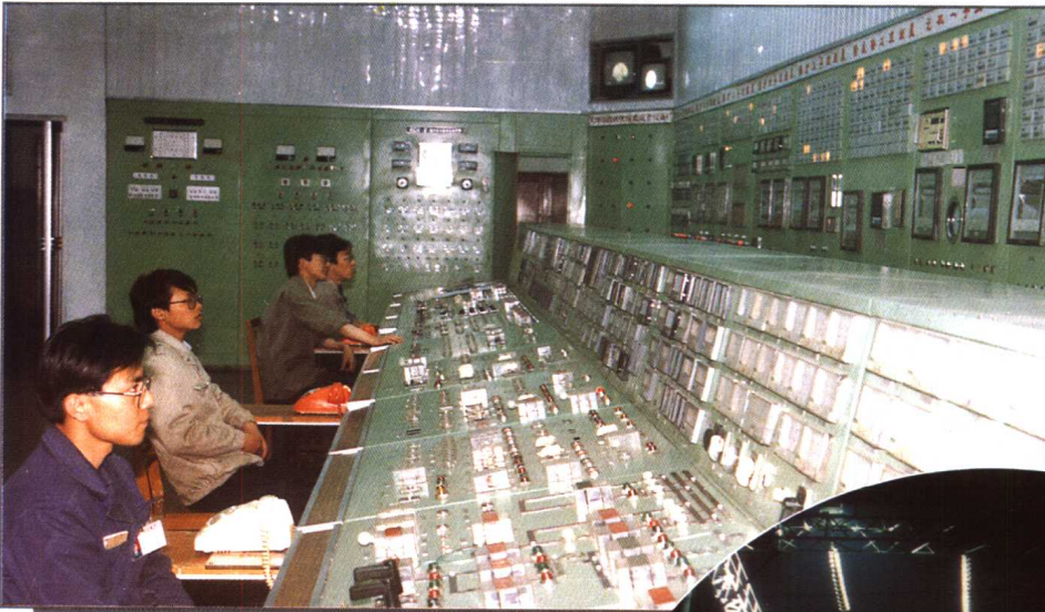
20万千瓦机组集控室。
