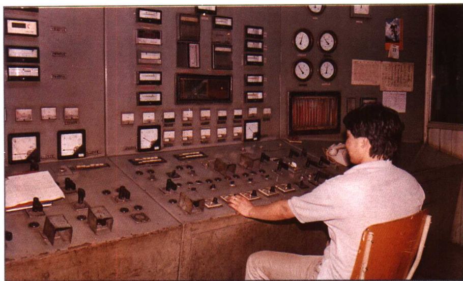
1.2万千瓦机组锅炉控制室。
