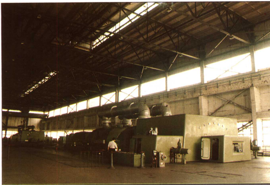
两台20万千瓦机组汽机房。
