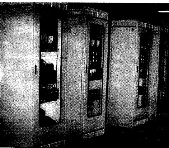
泰县节能电器设 备厂，这是该厂生产 的TGN镉镍电池电 源柜系列柜
