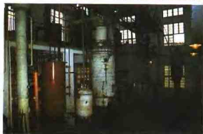
注滋口油厂浸出油车间
