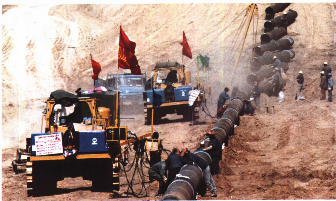
涩宁兰管线是目前世界海拔最高的输气管线，平均高度在海拔3000米以上
