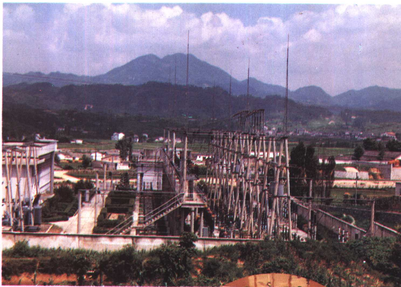
华东电网旌德 11万伏变电站
