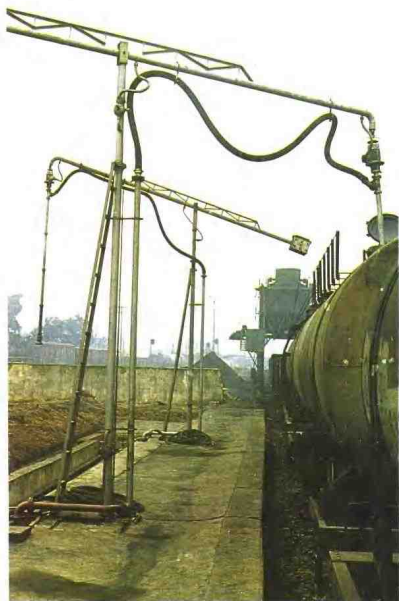
义乌油库铁路槽车卸油泵
