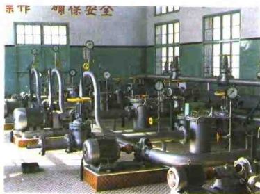
宁波石浦水封 油库码头泵房
