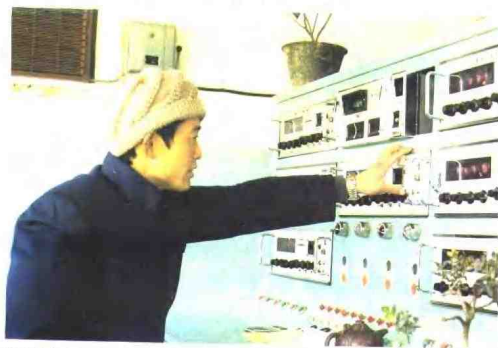
湖州苏台山油库电子数显付油仪表集中控制室
