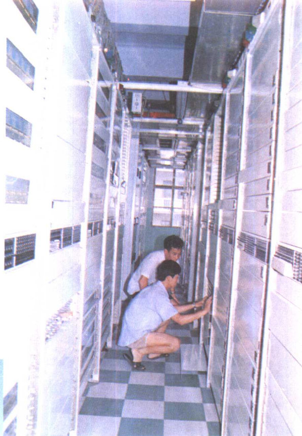
县邮电局电话自动化机房
