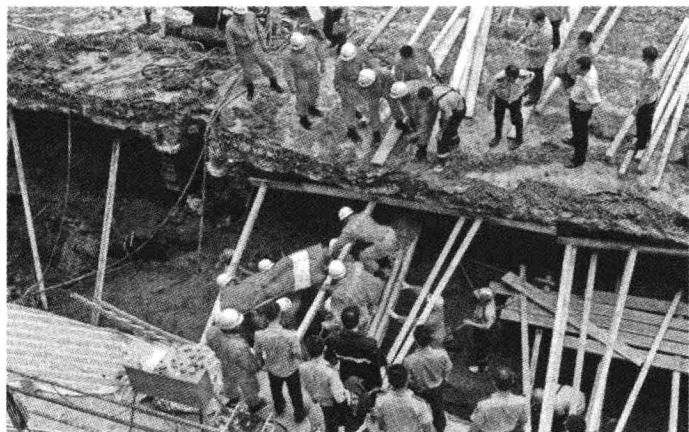
图 1-3 西安地铁施工事故救援现场
