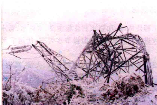
冻雨灾害损害电塔
