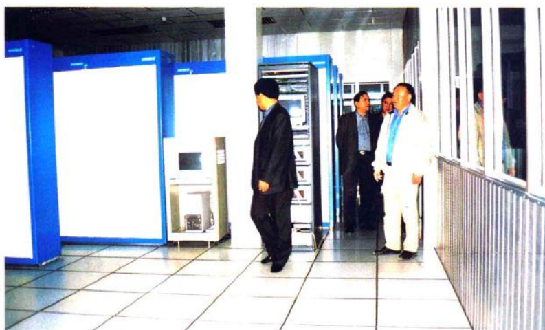
自治区邮电管理局副局长高鸿庆视察克拉玛依市邮电局自动机房
