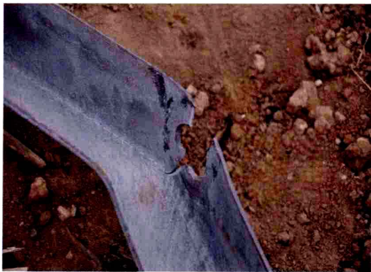
图 1-2 螺栓孔被撕裂的塔材
