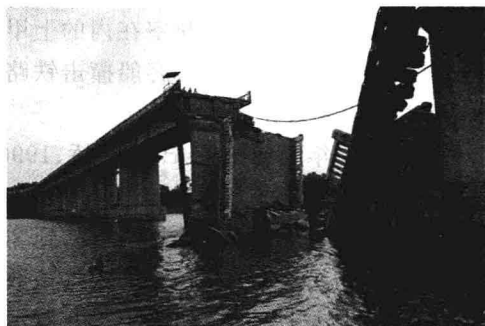
图 1—17 印度德拉贾桥梁坍塌
