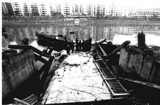
图 1—21 重庆綦江县彩虹桥发生坍塌
