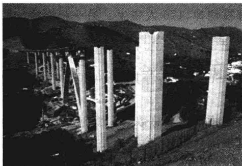
图 1—16 西班牙格兰纳达高速公路桥坍塌
