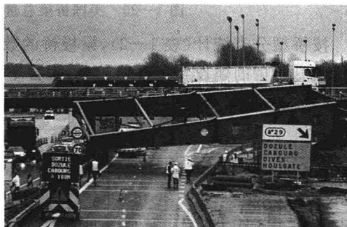
图 1—19 法国诺曼底高速公路桥倒塌
