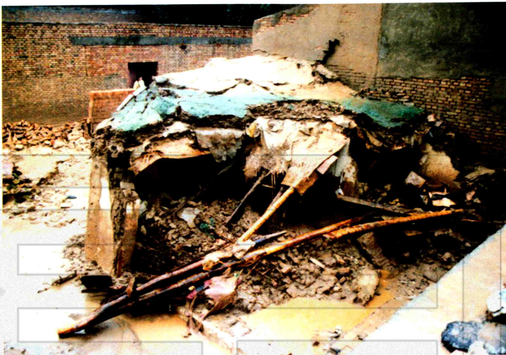
暴雨过后倒塌的房屋（青海，1999年8月）
