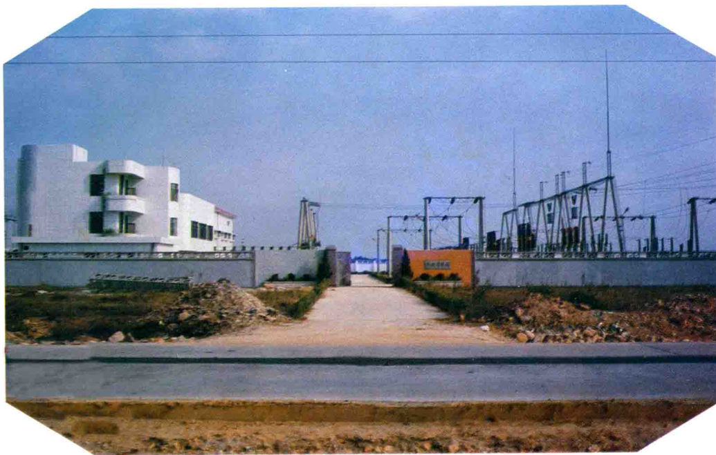
东坑镇变电站
