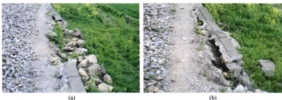
图 2-4 塌落型病害表现形态
