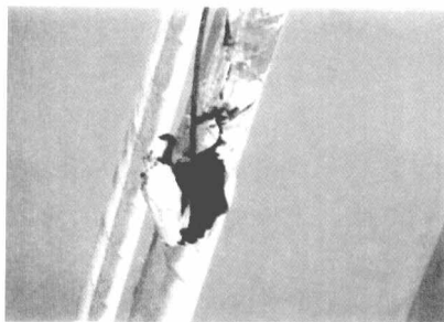
斜拉索HDPE套管裂缝和破洞,两股钢绞线松
