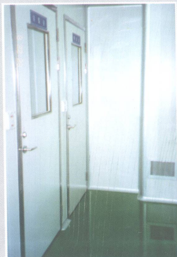
动物实验室走廊和排风管道（阴阳角为弧形）
