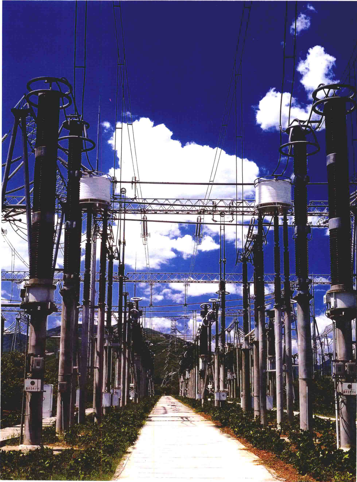
1991年12月投产运行的昌平500千伏变电站
