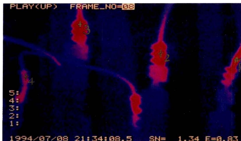
图 H11 高压断路器外部连接件接触不良
