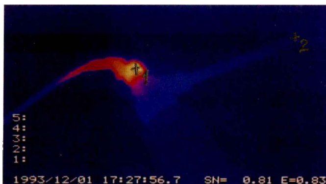
图 H37 110kV隔离开关引线接头接触不良
