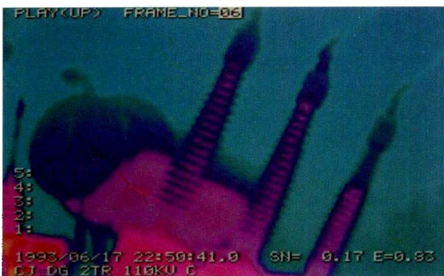
图 H9 变压器高 压侧套管因渗漏 而缺油
