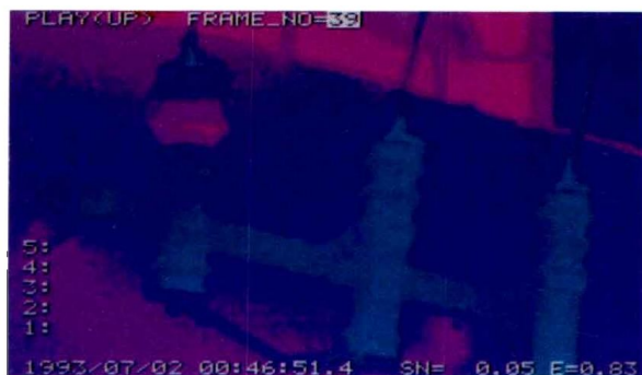
图 H27 FS 型 10kV 配电避雷 器内部受潮
