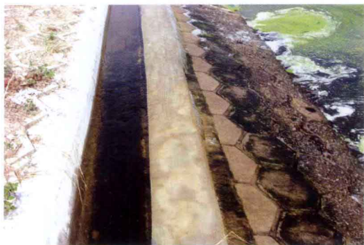
外环河湿地处理后出水
