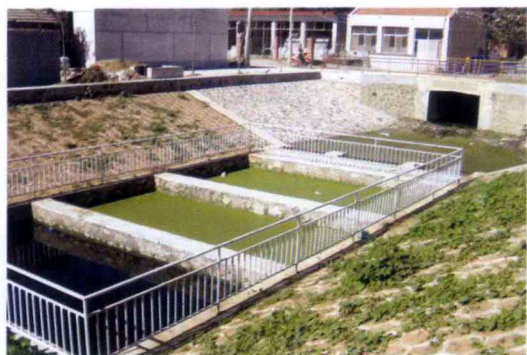
刘相营污水处理沉淀池
