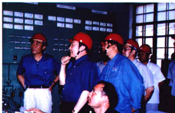
新疆电力公司总经理张铭洲(中)由塔城地委副书记张其洲(左一)陪同在铁厂沟电厂主控室视察生产运行情况
