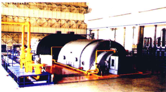
铁厂沟电厂5万千瓦发电机组
