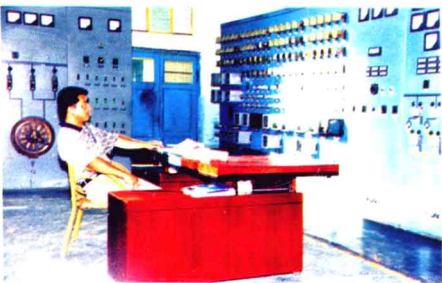
玛勒热苏水电站主控室 (3×500千瓦)
