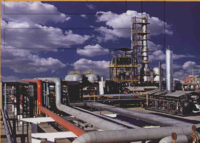
吐哈油田鄯善采油厂联合站
