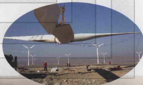
兴建大型风力发电厂
