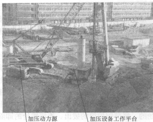
图2 加压设备安装后
