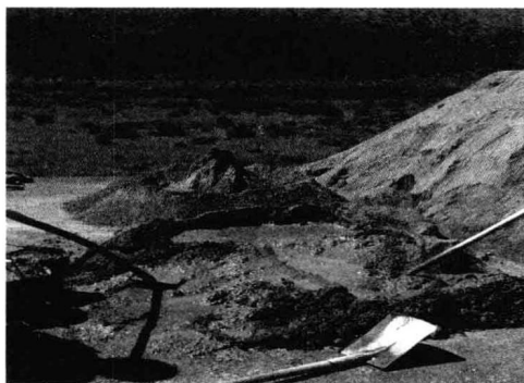
图 1.4 绿化施工污染油路
