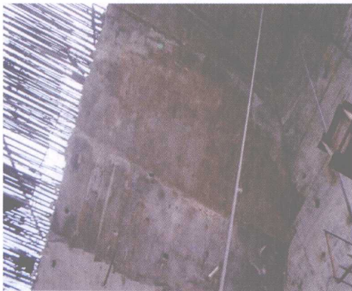
▲ 模板不干净或脱模剂差，混凝土外观较差
