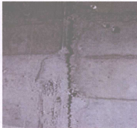
▲ 接缝位置未处理好，产生漏浆
