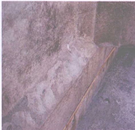
▲ 模板不干净或脱模剂差, 混凝土外观较差
