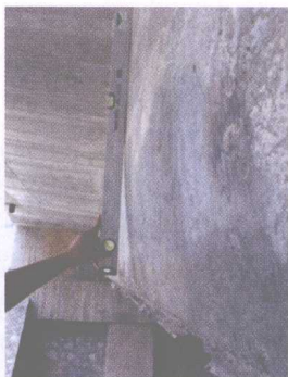
▲ 模板刚度不足导致局部胀模
