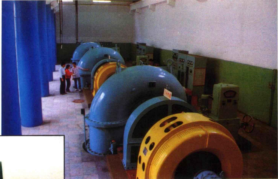
△ 湖北白莲发电设备制造厂生产的 HL240-WJ-71水轮机、TSW143/39-12型 630kW 6.3kV 水轮发电机
