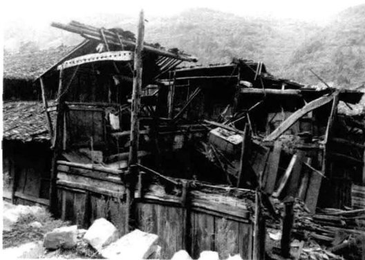
图8 损毁中的乡土建筑
