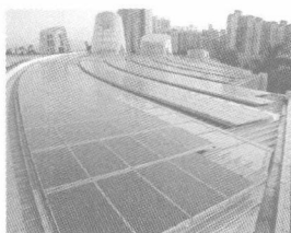
太阳能屋顶发电站
