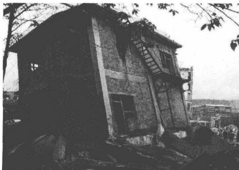
图 1.4 地震中破坏的房屋
