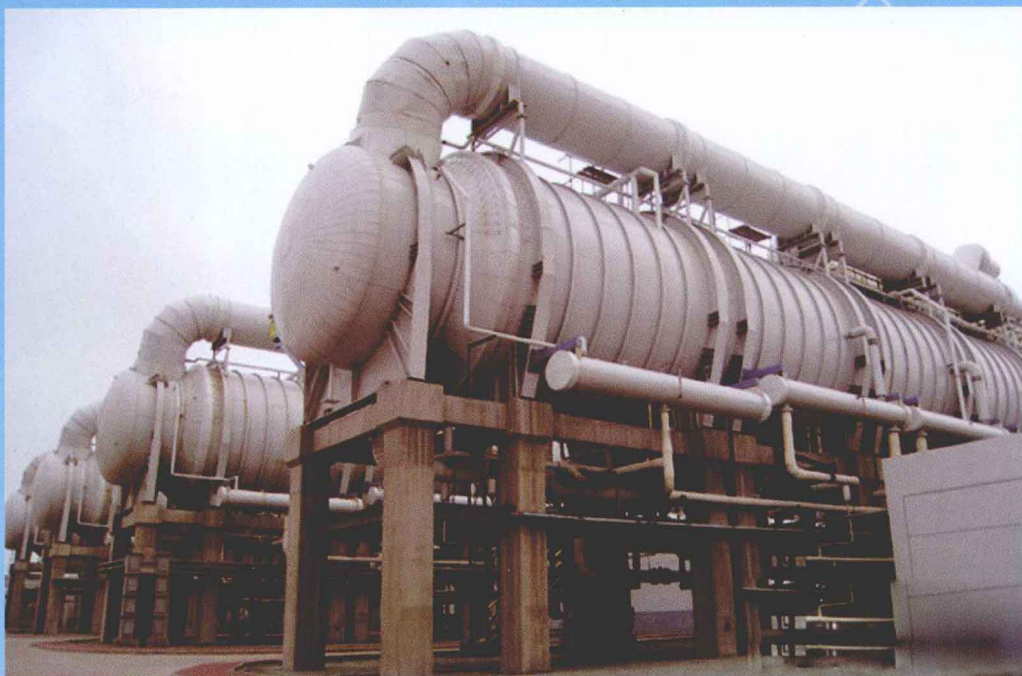
2010年5月28日，国家循环经济试点企业国投天津北疆发电厂海水淡化一期项目建成投产，日产淡化海水10万吨，向滨海新区源源不断地提供高纯度淡化纯净水
