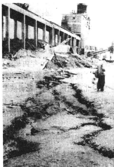
图1-7 唐山地震中的重力地裂缝
