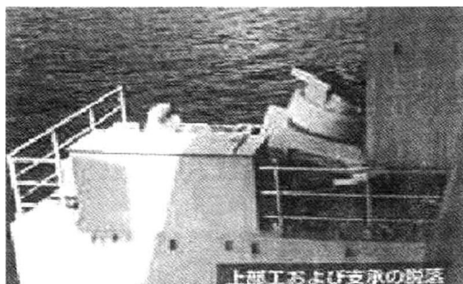
图 1-5 日本某桥梁体与支座滑落
