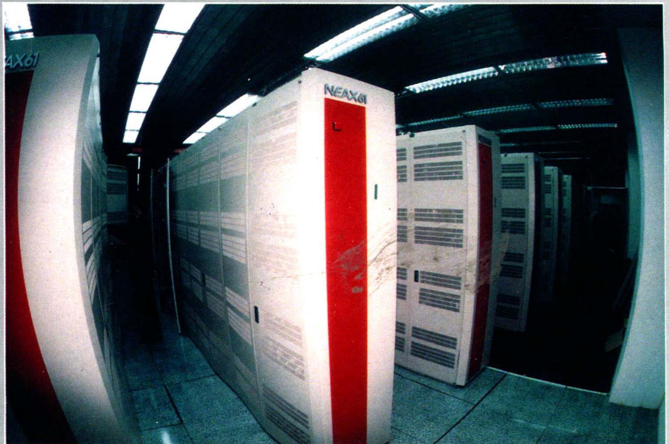
深圳市邮电局程控电话机房
