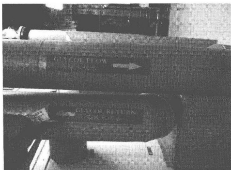
图 1-3 冷冻水供水、回水标识
