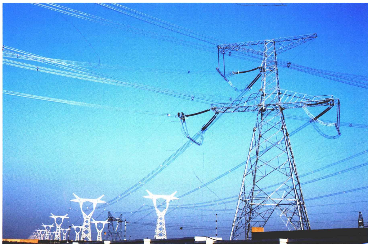
750 千伏线路巍峨耸立的铁塔
