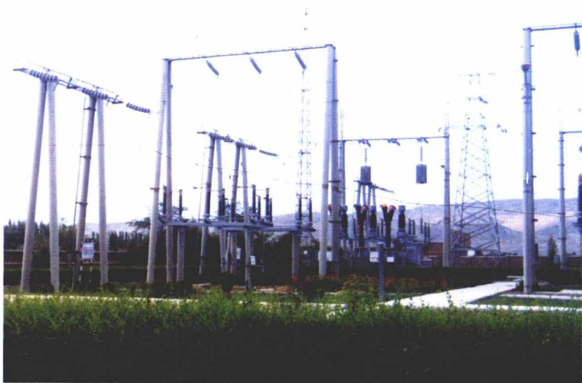
110 千伏葡萄沟变电站
