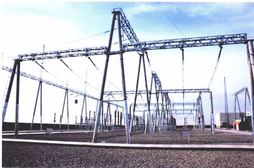
220 千伏小草湖变 电站设备区
