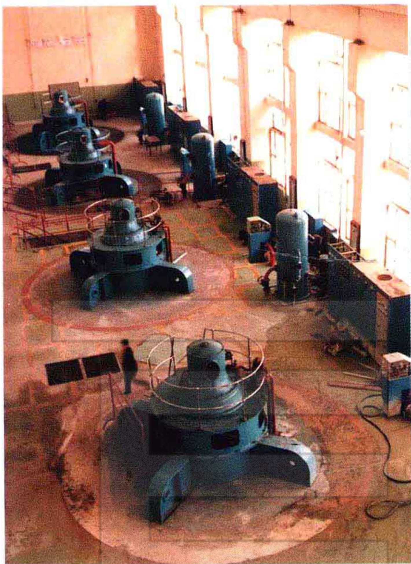
西大桥水电站机房一角
