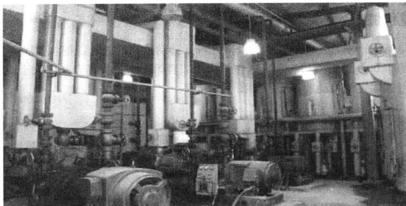
图 1-3 冷库压力管道外观
