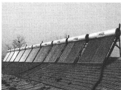
图1-12 太阳能热水系统在建筑中的应用2
