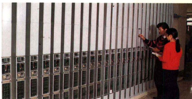
④ 數字光纖傳輸通信設備三次群光，電端機生產調試
