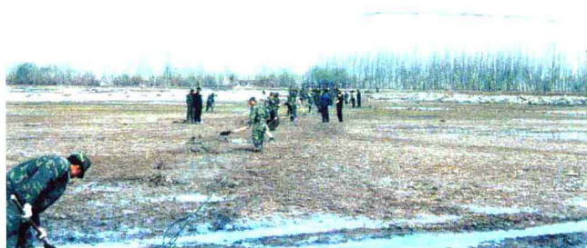
(左图)新疆自然环境恶劣，光缆施工难度大，苦累多。图为南疆光缆阿克苏段施工掠影。
