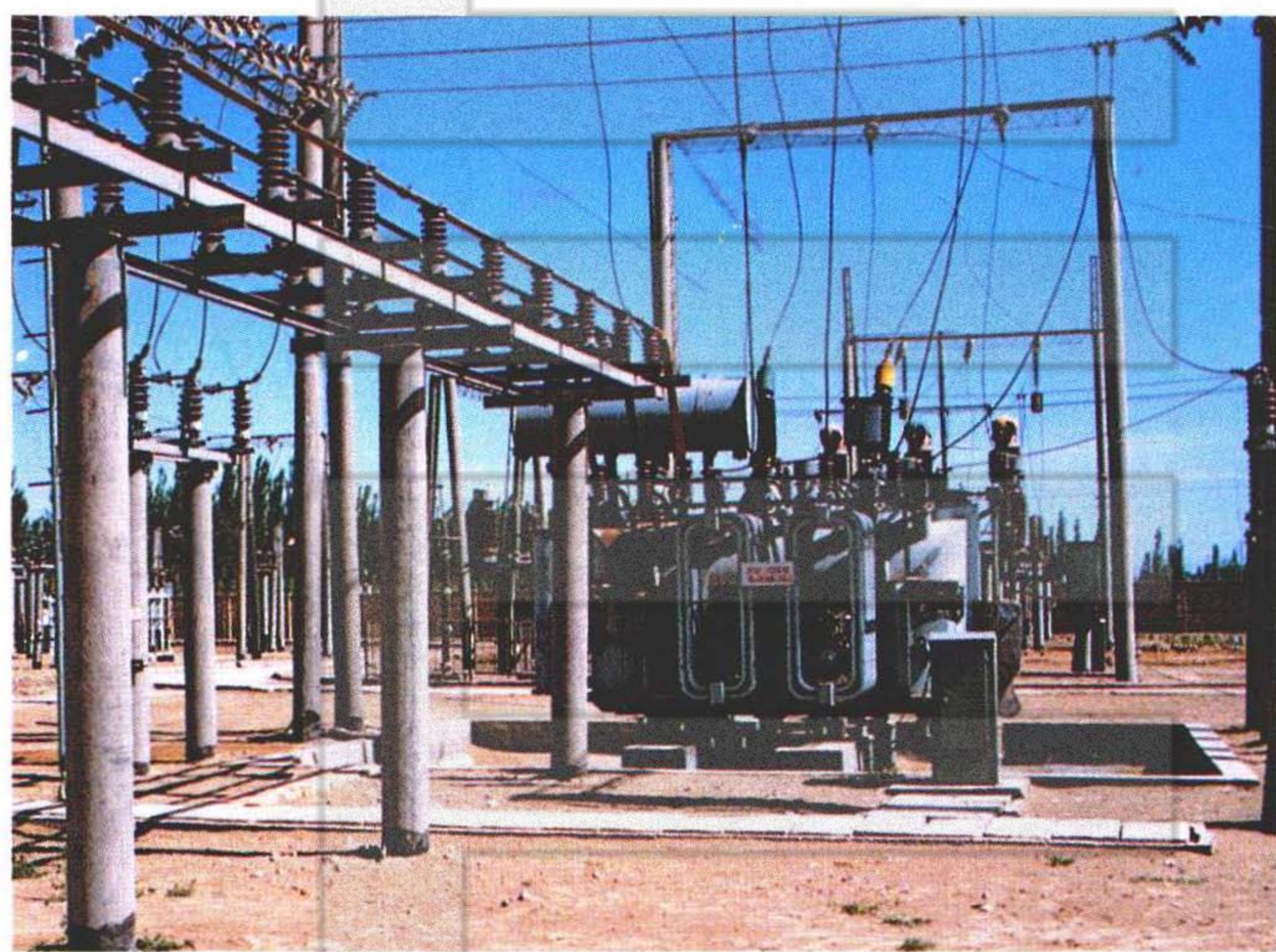
电力公司变电站
