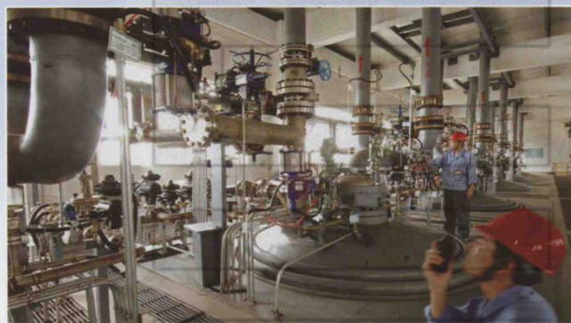
聚合釜装置现场
