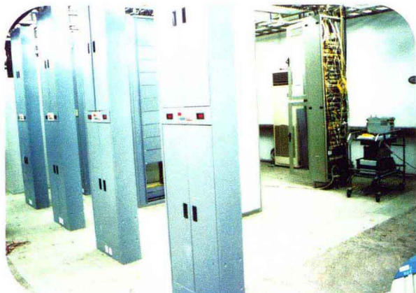
光缆传输机房
