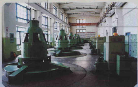
团结电站机房
