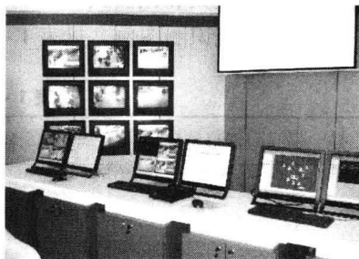
图1-1 安防监控系统监控中心
