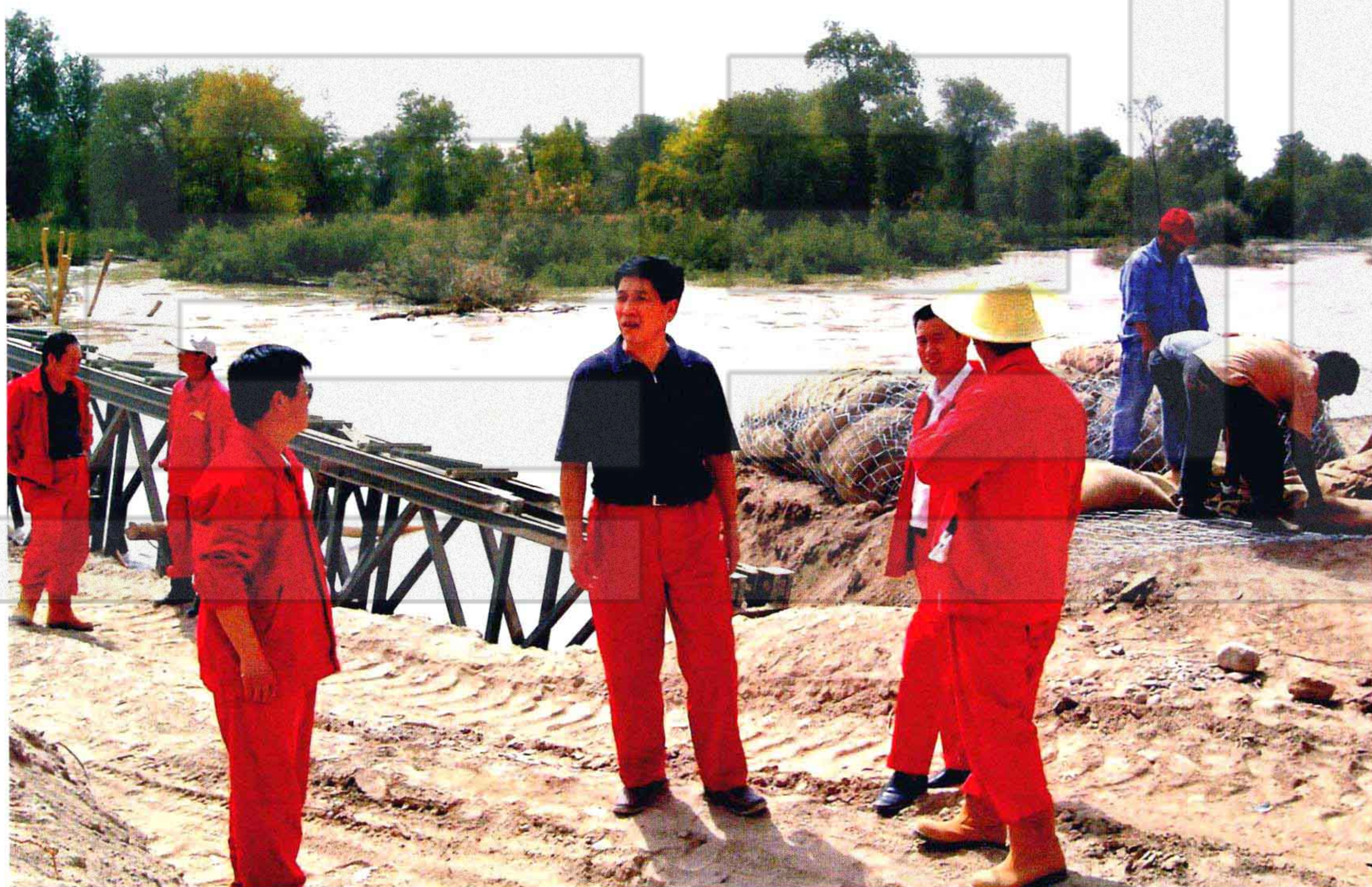
2006 年 8 月 11 日,塔河油田 S112 井区的过河大桥被洪水冲垮,西北石油局党委书记陈云华(中)在现场指挥抢险。 (牟雪江 摄)
