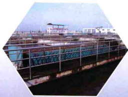
污水处理厂氧化沟
