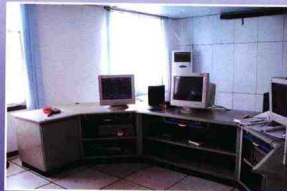
污水处理厂中控室
