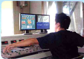
全自动配料主控系统操作台
