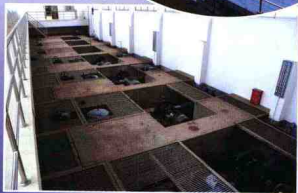
第五水厂泵房
