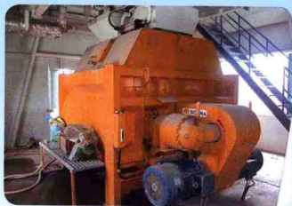
混凝土搅拌装置
