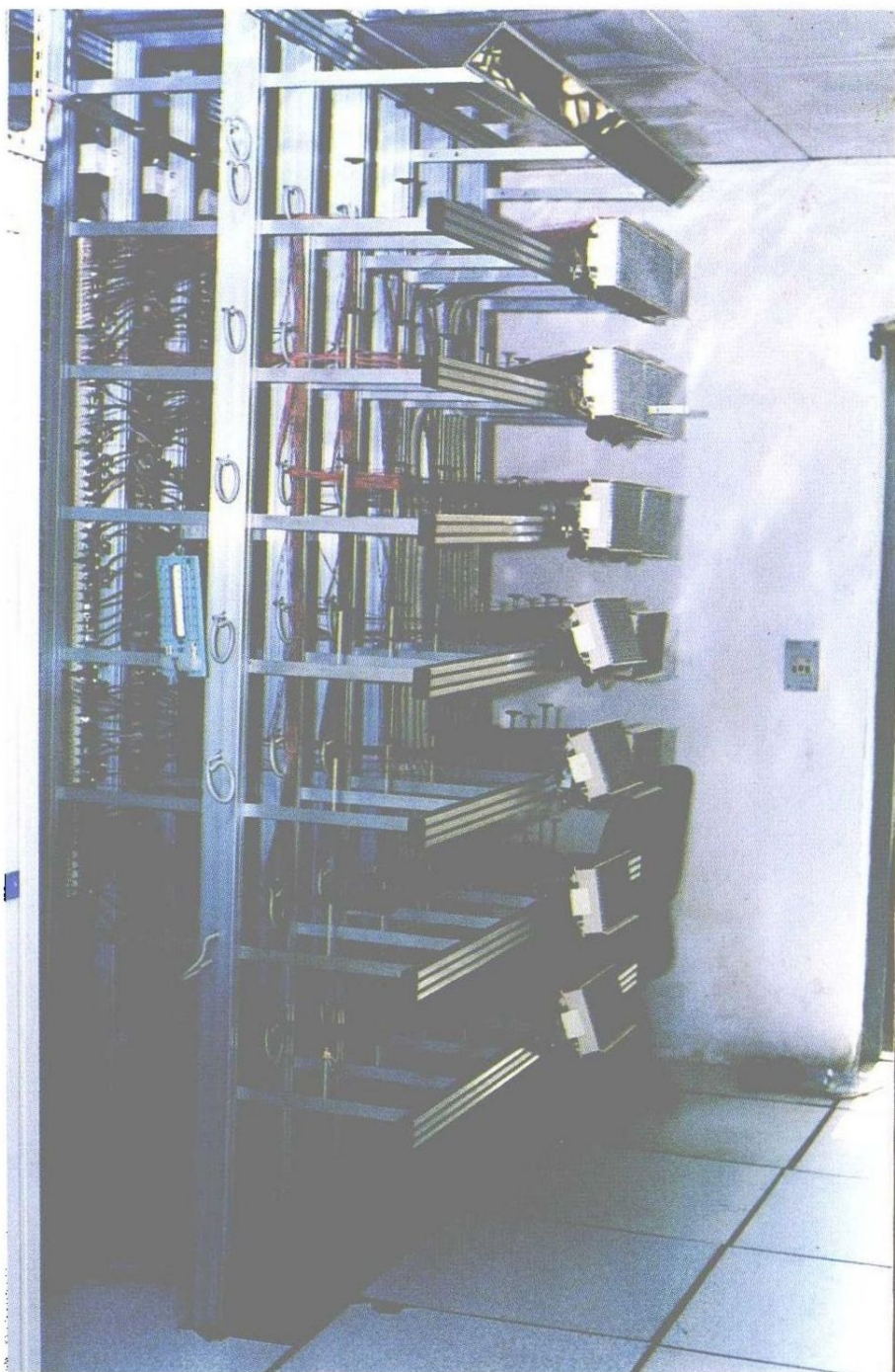
▲ 金甲岭程控电话载波室
